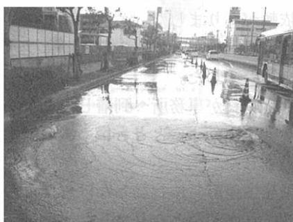
図－7 漏水・道路規制状況
