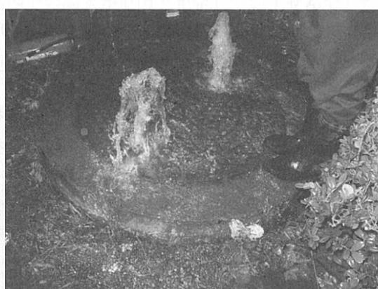
図-15 マンホールからの漏水状況
