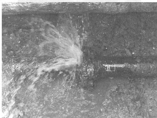
図-11 漏水（φ100）状況
