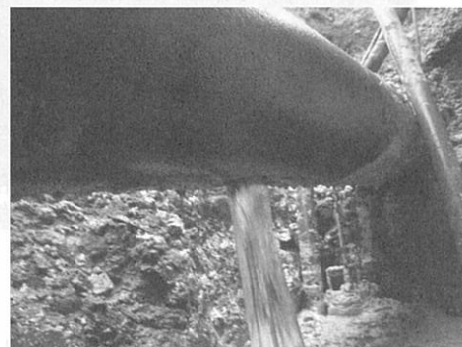
図－9 漏水状況・管底腐食穴
