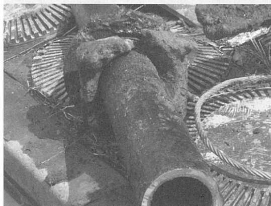
図-13 継手部（φ75）破損
